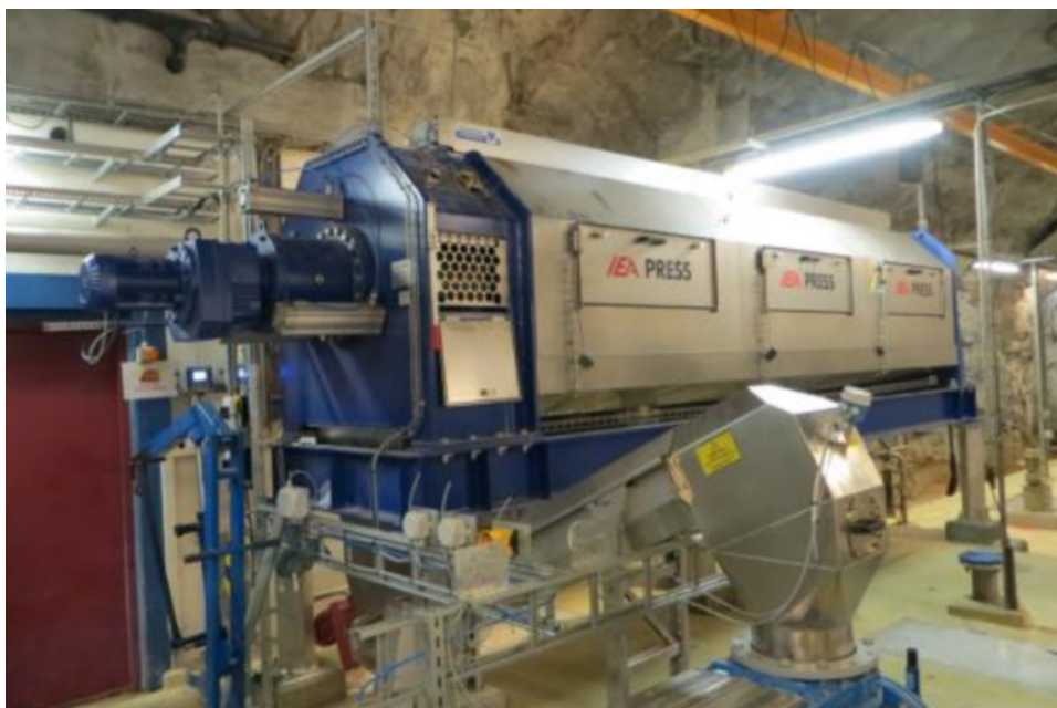
Figur 2. Skru presse type IEA fra leverandør Hjortkær A/S i Danmark. Installasjonen vist er ved Odderøya RA i Kristiansand.
